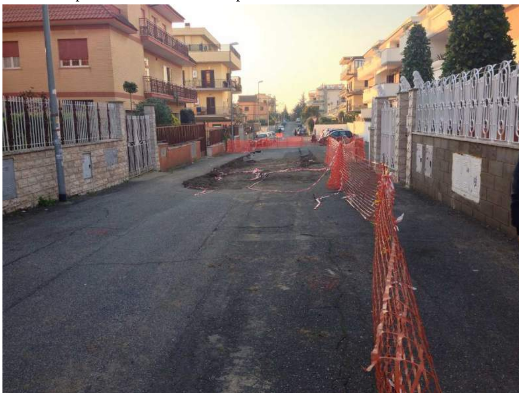
Cedimento manto stradale
